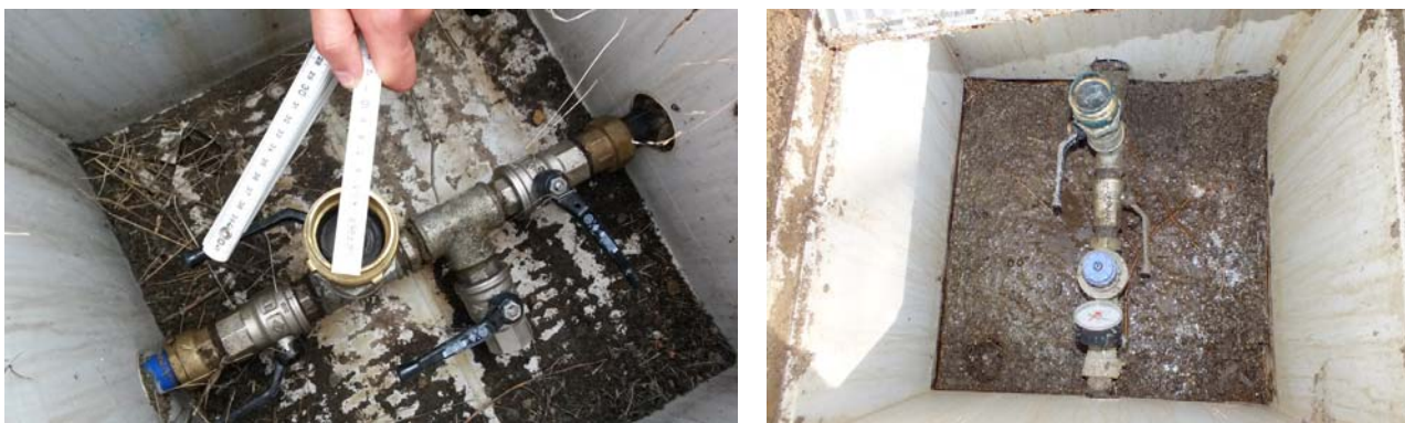
Figura 17. Esempio di raccordo per manichetta antincendio in un pozzetto di una condotta interrata per l'adduzione di acqua per l'abbeverata.
